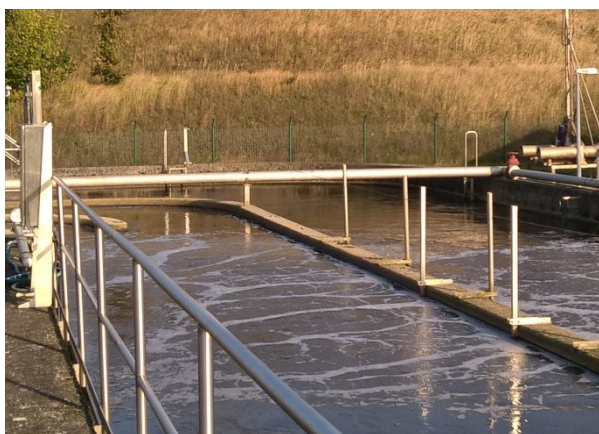
Abb. 1: Kläranlage Kneese während und nach der Montage der MESSNER-Plattenbelüfter ® in aushebbaren Rahmen
